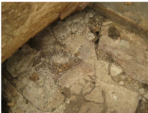
Befall von Echtem Hausschwamm auf der Mauerkrone.
