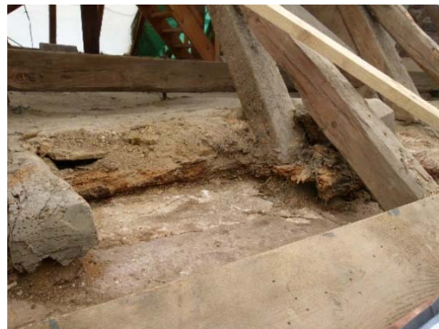
Zerstörte, teilweise fehlende Fußschwellen.
