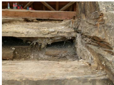
Befall von Echem Hausschwamm zwischen Deckeneinschub und Stuckdecke.
