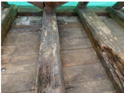
Durch pflanzlichen Befall geschädigte Deckenbalken.
