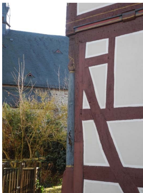
Eckständer vor der Instandsetzung.
