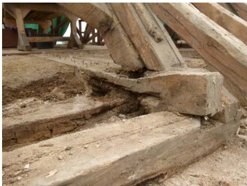
Vollkommen zerstörte Deckenaufleger.
